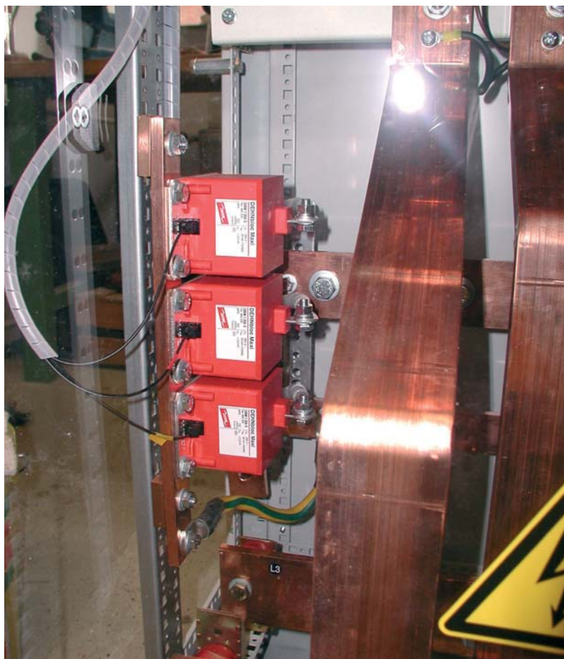
De componenten in een hoofdverdeler dienen bij kortsluiting tot 4 kV te kunnen worden belast. Bij een inslag maakt de component daarvan één potentiaal op de fase, de aarde en de nul. Er lopen dus geen stromen.
